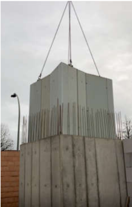
Abb. 95: Klappschacht am Kran
